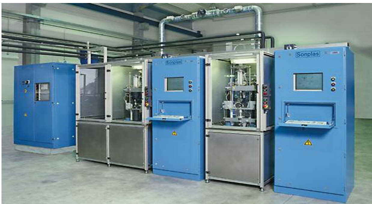
Gesamtansicht von Einzelinjektor- und Dichtheitsprüfstand, sowie zentraler Schaltschrank der Kraftstoffnieder- und -Hochdruckversorgung
