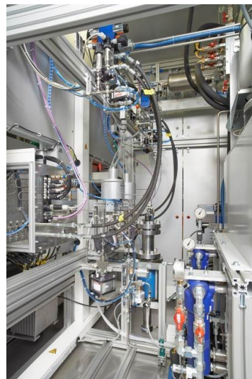
Medium- und Hydraulikversorgung
