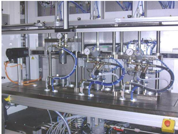
Vorrichtungsraum mit 2 Schleifstationen und 1 Spülstation
