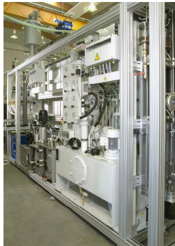
Hydraulikaggregat und Medientanks
