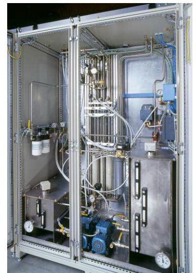
Hydraulikschrank mit Kraftstoffversorgung
